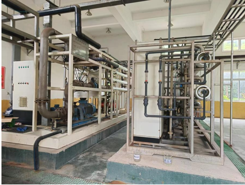
废水处理车间
