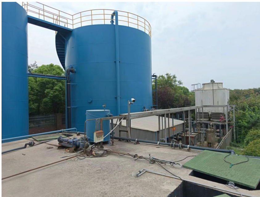
废水生化处理设施
